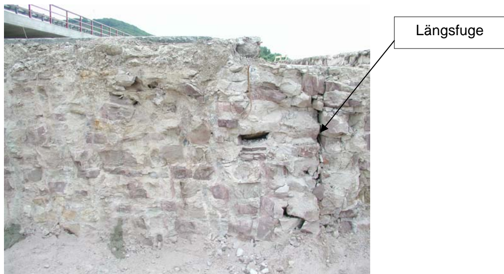
Bild 22: Mauerwerk der Auffüllung im Bereich der Querträger in Achse A und 1. Das sichtbare Zwickelmauerwerk zeigt kleinere Klüfte.
